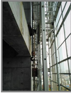
架体操作空间及电气模块箱
